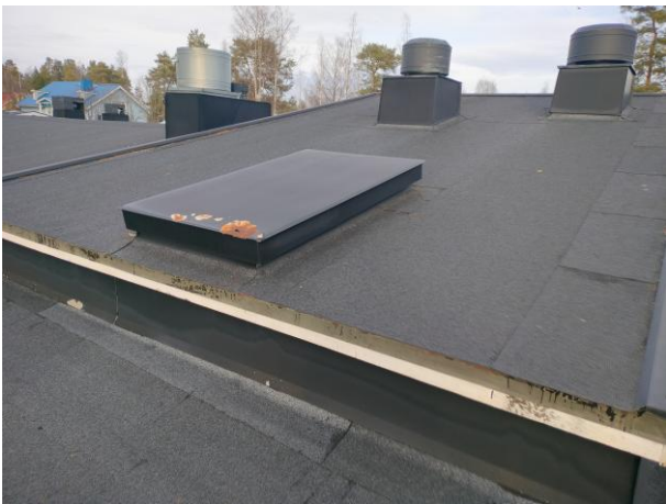
Tarkastusluukku ei saanut auki.
