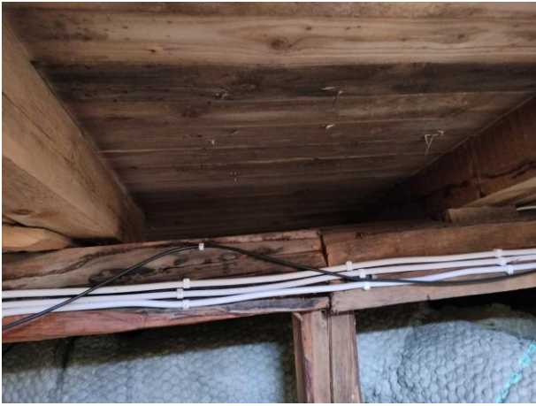
Katon laudoitus ja kantava palkki kastuneet.
