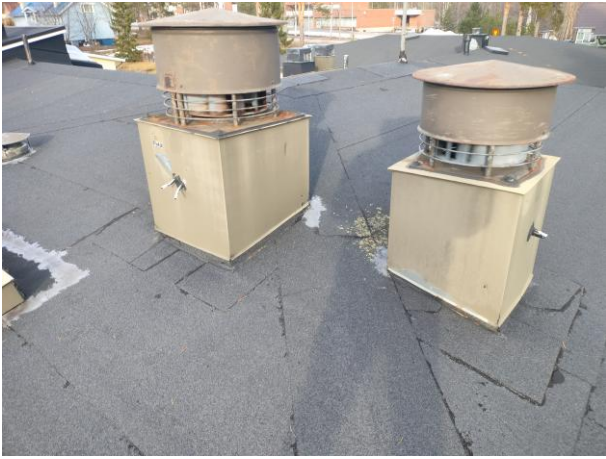
Iv-koneiden sähköläpivientien päällä tulisin olla katos.
