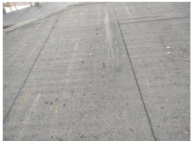
Pussin kohdalla kermi rikkoontuu helposti.
