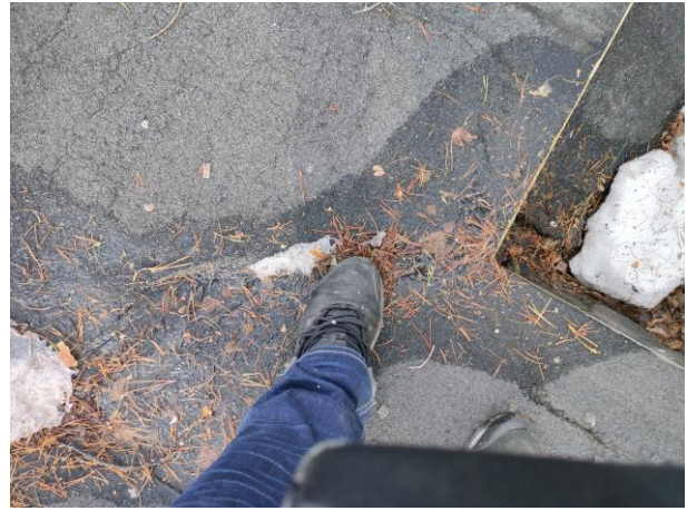
Alusta on jiirin pohjalla joustava. Mahdollinen kosteusvaurio.
