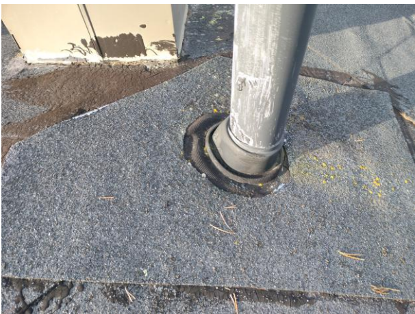
Viemärin tuuletusputken läpivientikumi on jo hapero.
