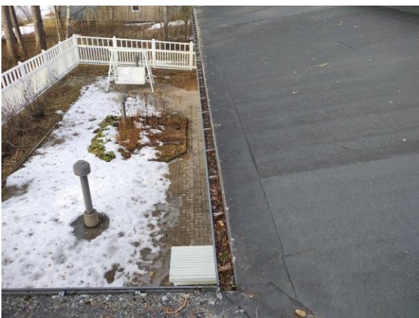
Kourua ei ole puhdistettu hetkeen.
