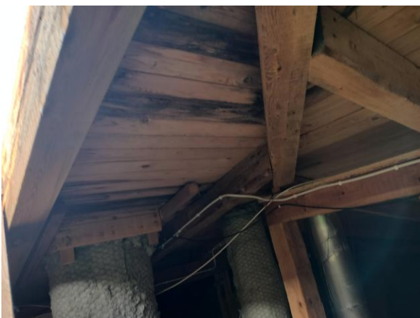
Ullakkotilassa näkyy katteen läpivuotoja.
