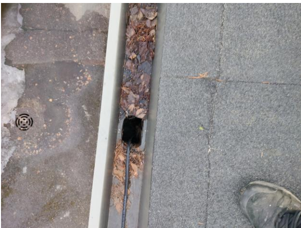
Kouruissa ja syöksyissä on osittain lämmitys.
