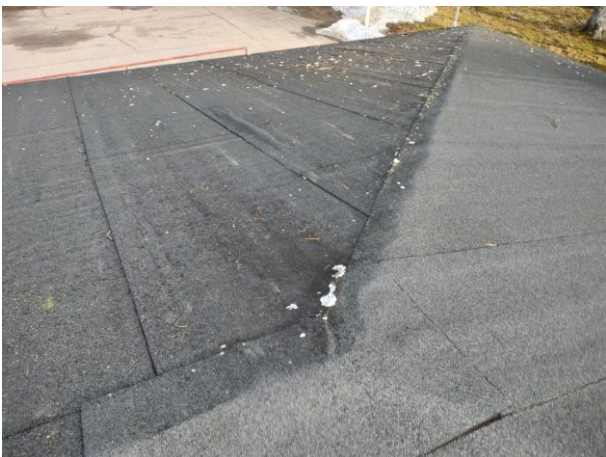
Paikoin katto on voimakkaasti kuprulla. Se tarkoittaa että kermien välissä on kosteutta, joka höyrystyy ja muodostaa ns. höyrypusseja.
