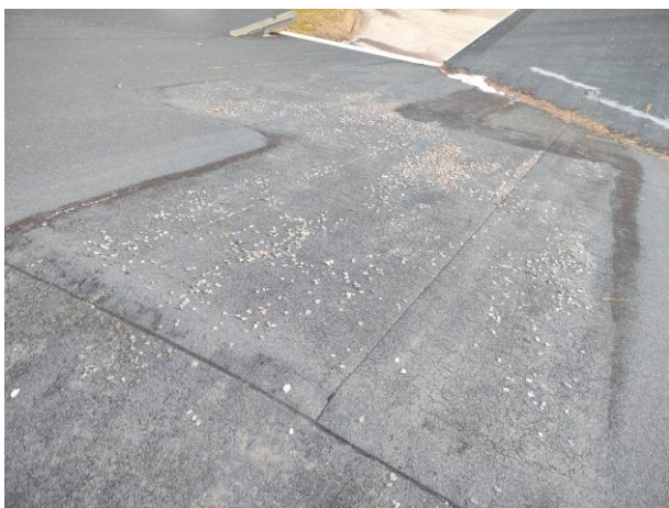
Katolla on yhdessä kohtaa paljon kiviä. Kivet voivat rikkoa kermin.
