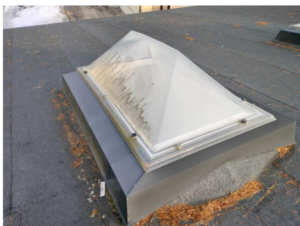
Osa kattoikkunakuvun kiinnikkeiden suojahatuista puuttuu.
