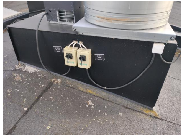
Suojaamattomat ja avonaiset sähköjohteet pellin läpi.
