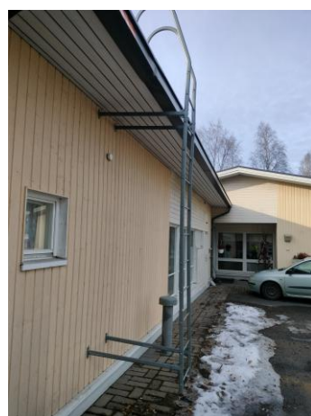
Tikkaita ei ole kiinnitetty räystäääseen. Ne joustavat vaakatuukien osalta.
